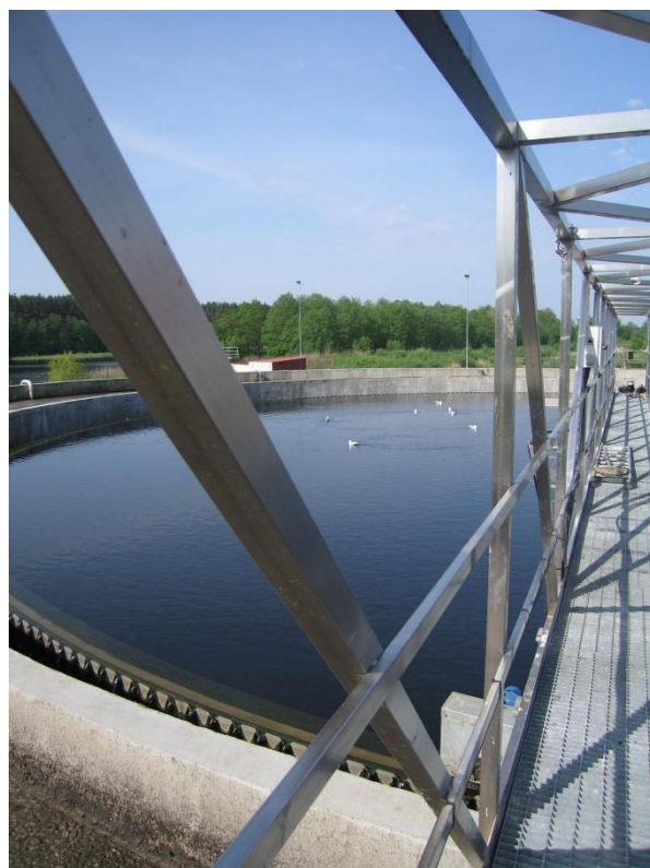
Jurmalan jätevedenpuhdistamo Kuva Hannamaria Yliruusi
